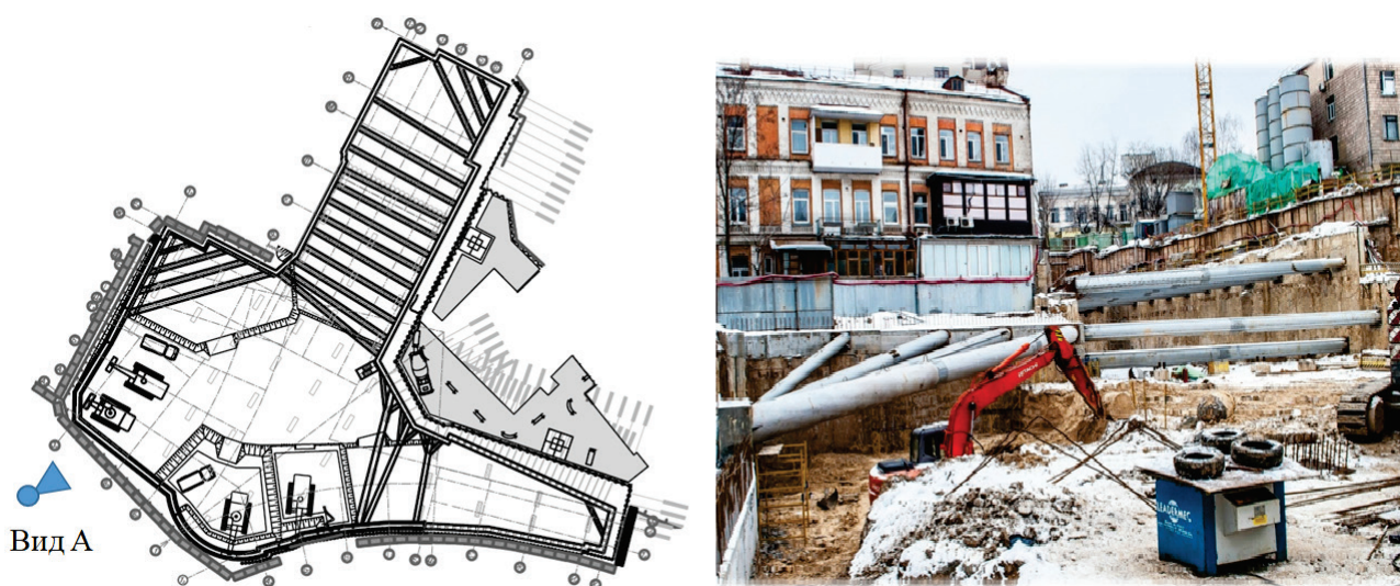
Рис.1 Производство работ по ограждению котлована в блоке В: а) план котлована; б) вид А;
